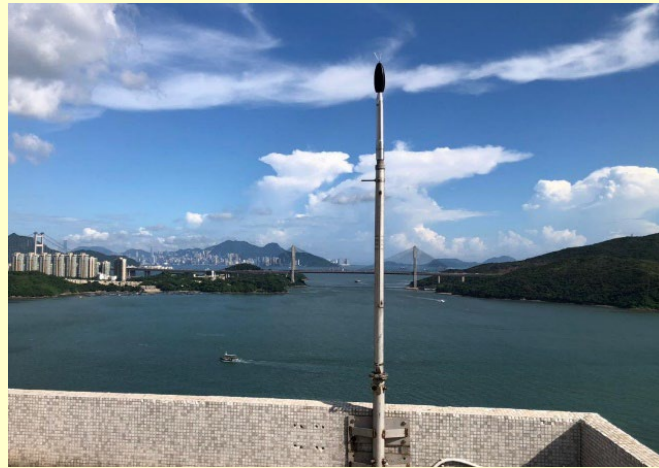
圖 2-4：戶外噪音監察站
