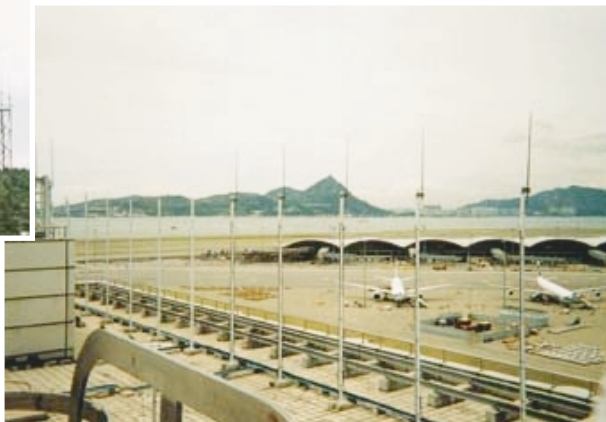
位於航空交通管制大樓上的天線場 Antenna Farm on Air Traffic Control Complex
